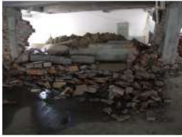
(d) OOP infill wall failure
